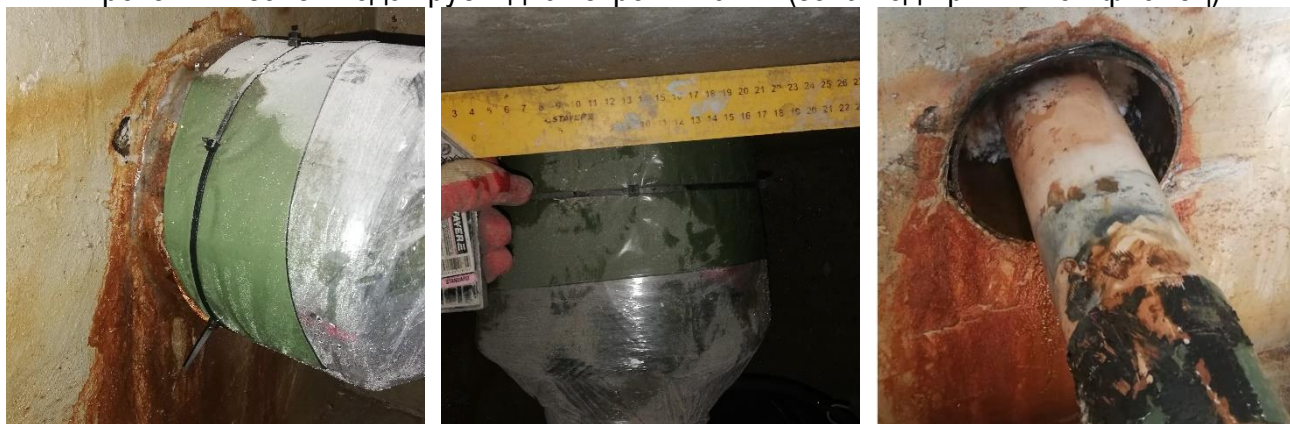
Протечки в зоне ввода трубы диаметром 110 мм (зона под прижимной фланец)
